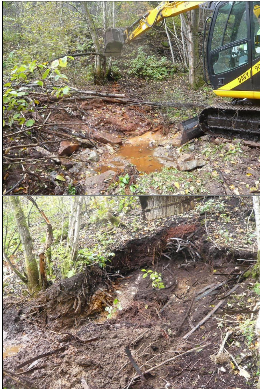
Bilde 2-8: Bilder av sjakt SJ7 (sigevannsutløp) i den nordøstlig delen av nedre deponi. Øvre bildet: Sigevannutløpet rett før avgravning. Nedre bildet: Etter at det er gravd ned til fjell. Sigevann renner ut mellom fjell og et ca. 40-60 cm tykke lag, som består av rustent bandjernlag, og et tykkere vegetasjonsdekke med rik organisk jord, sand, grus, steiner, kratt- og trerøtter.
